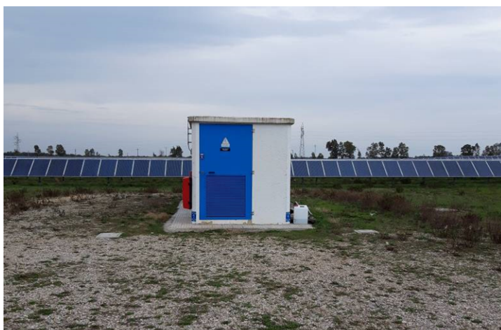
Figura 11. Posto de transformação e seccionamento.
