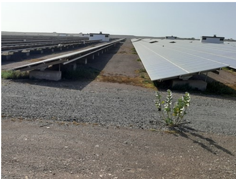
Figura 10. Exemplo de painéis fotovoltaicos e respectiva estrutura de suporte; cabines de transformadores ao fundo (Fonte. Google)
