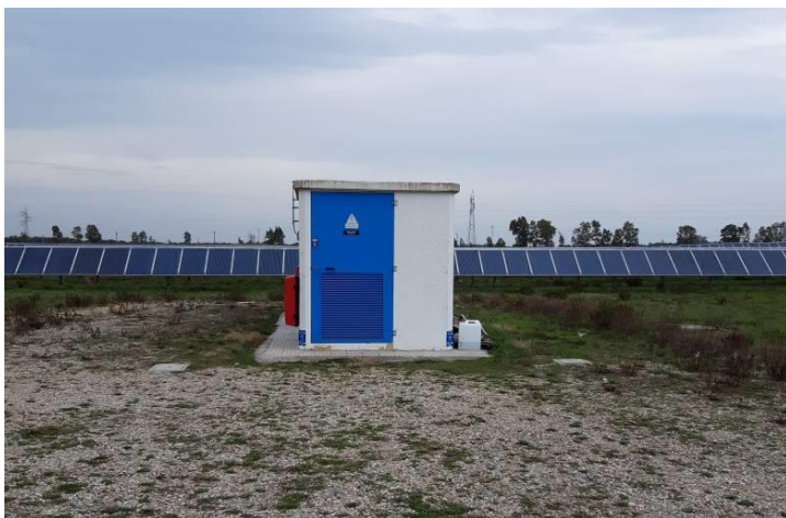
Figura 3-6. Posto de transformação e seccionamento.
